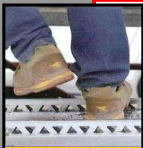
Camminare sempre sul correntino aluzinc
